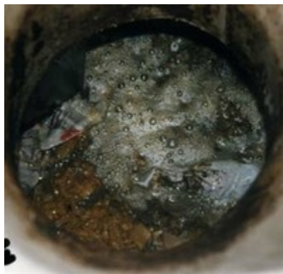
MINI PIT TOILET BEFORE PIT TOILET EVAPORATOR
