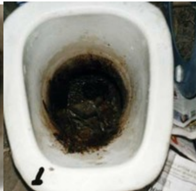
MINI PIT TOILET AFTER PIT TOILET EVAPORATOR
